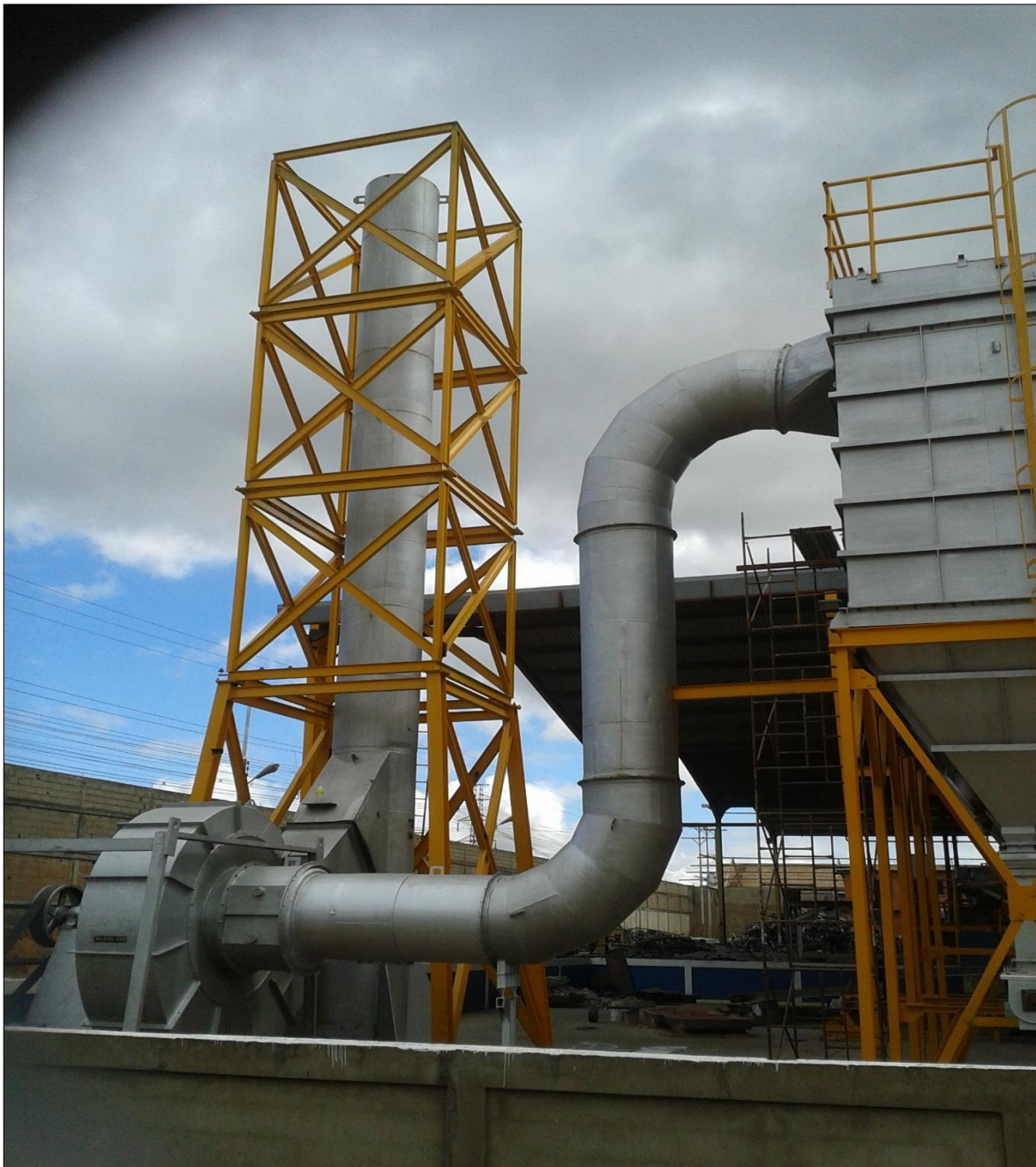
Ventola y chimenea que permite extraer aire limpio libre agentes de contaminantes
