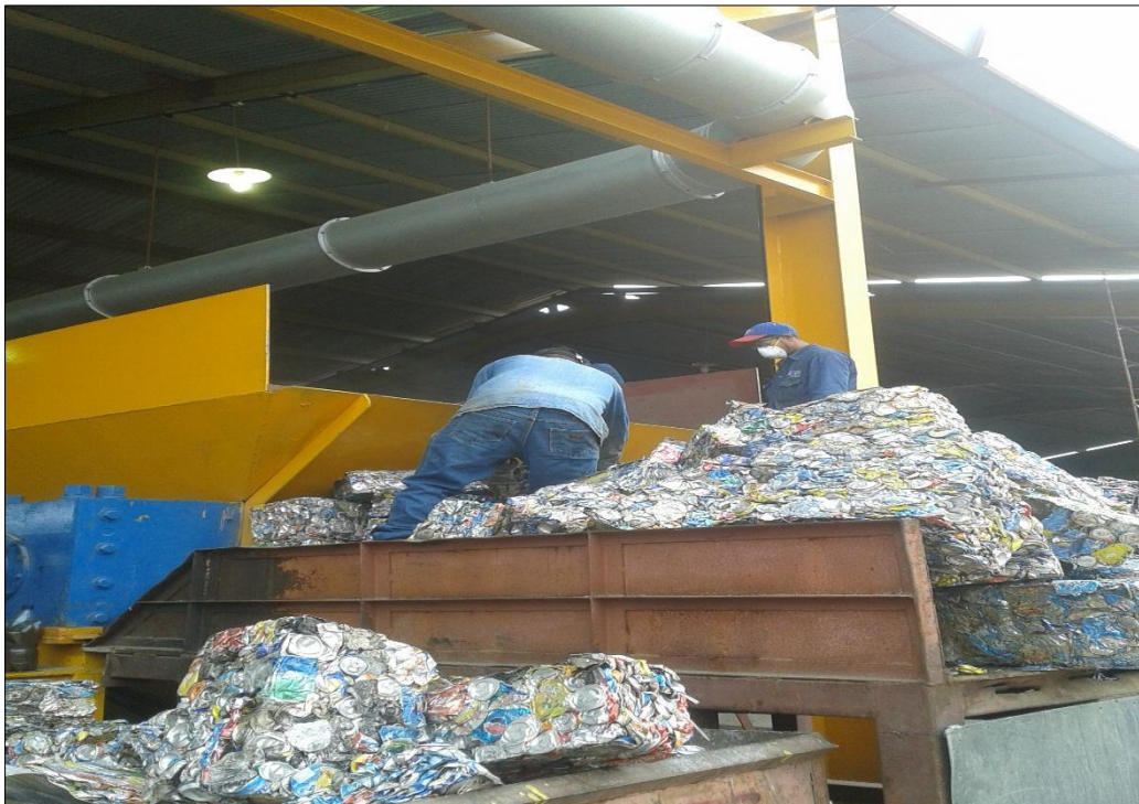
Molino triturador: sistema electro-mecánico para trituración de material (potes o latas de aluminio)
