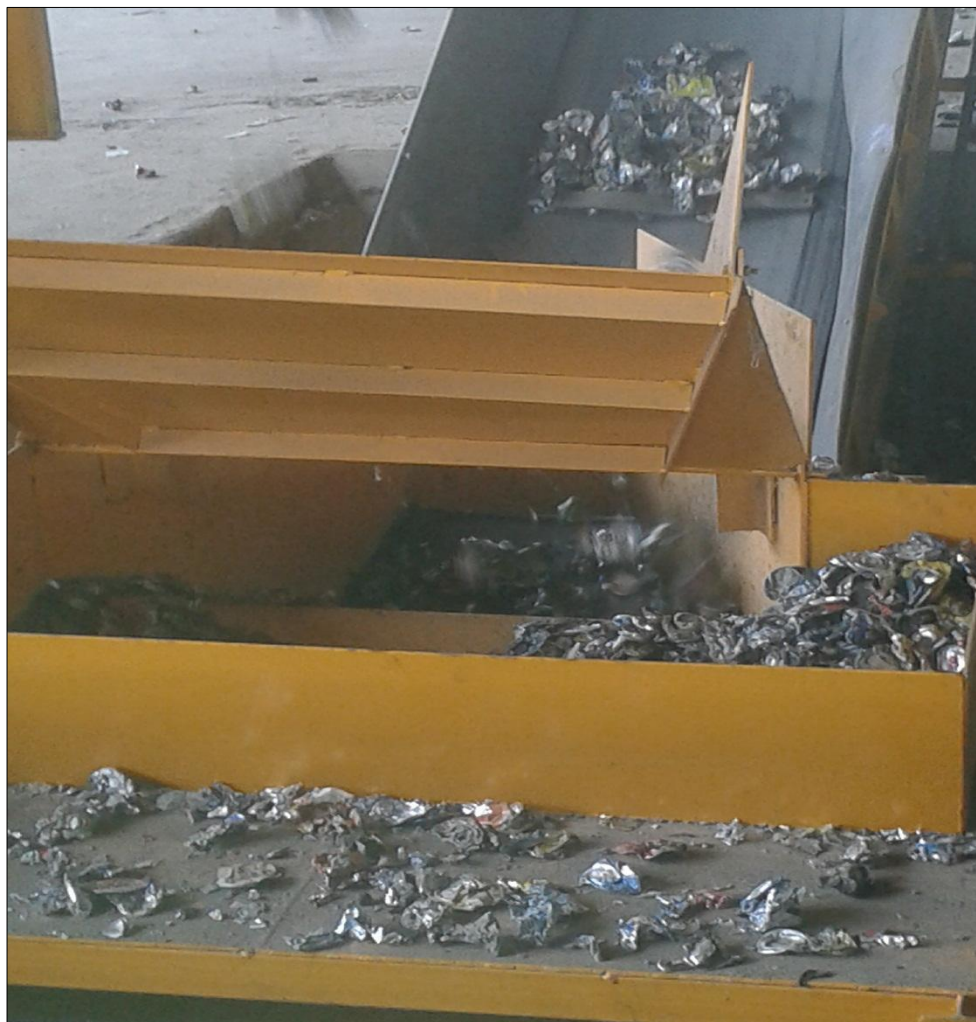
Tolva recolectora material Limpio.
