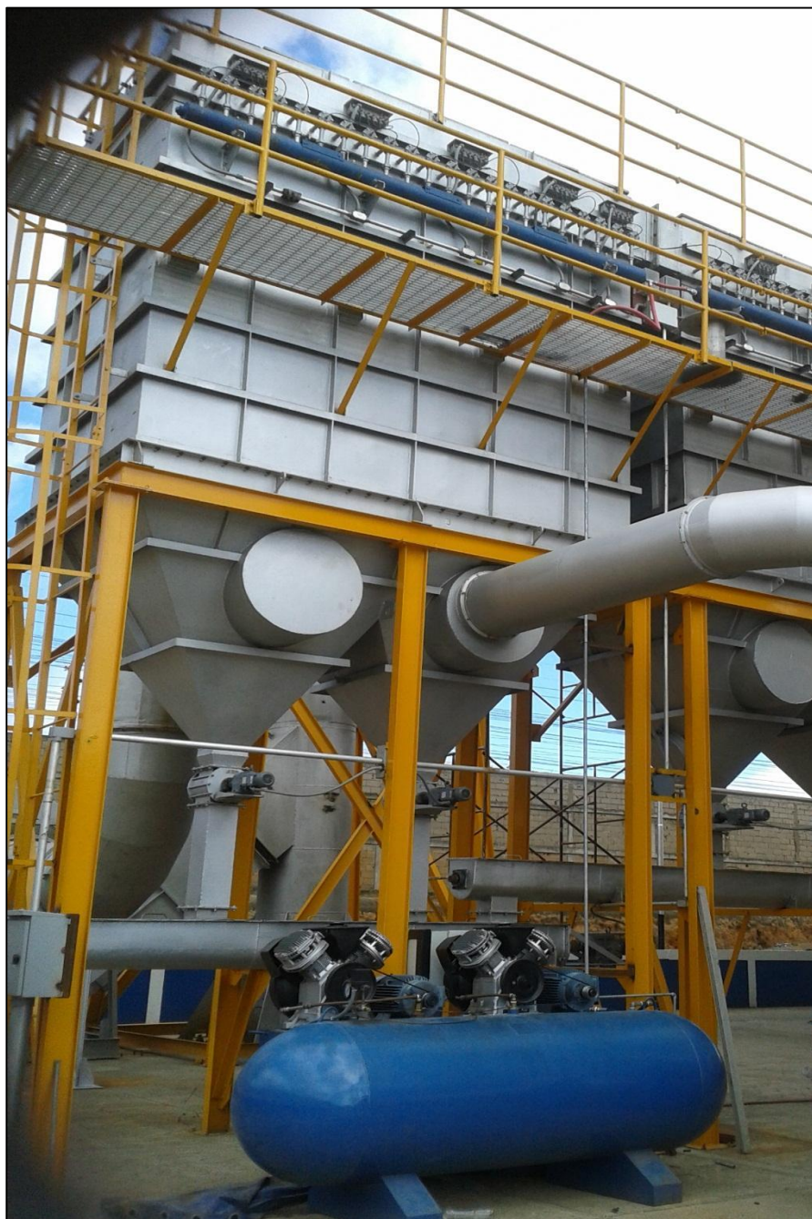
Sistema de mangas que permite limpiar el aire antes de salir por la chimenea
