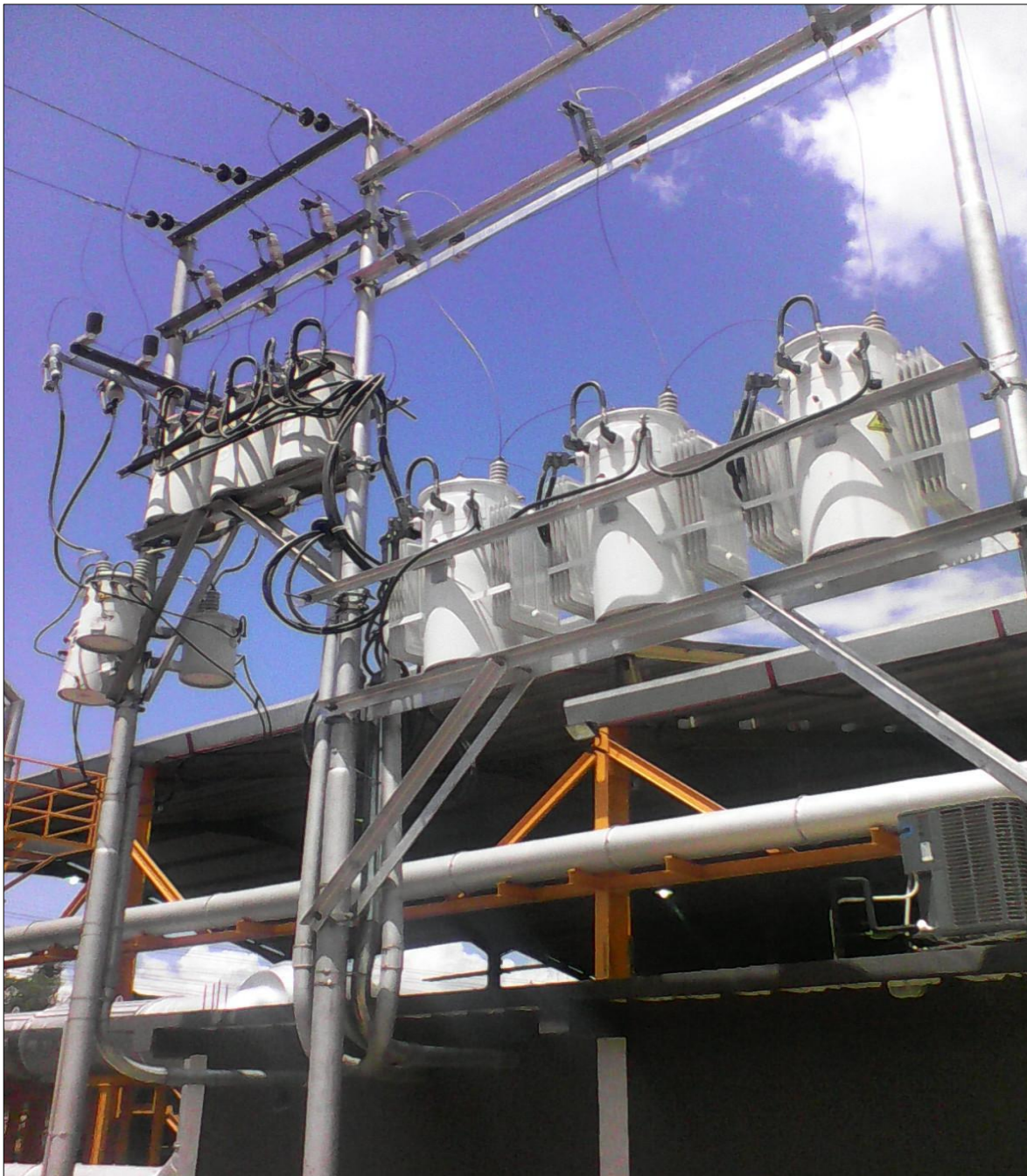
9 transformadores (3 de 25 kva, 3 de 100 kva y 3 de 167,5 kva) destinados a la alimentación de la línea 3
