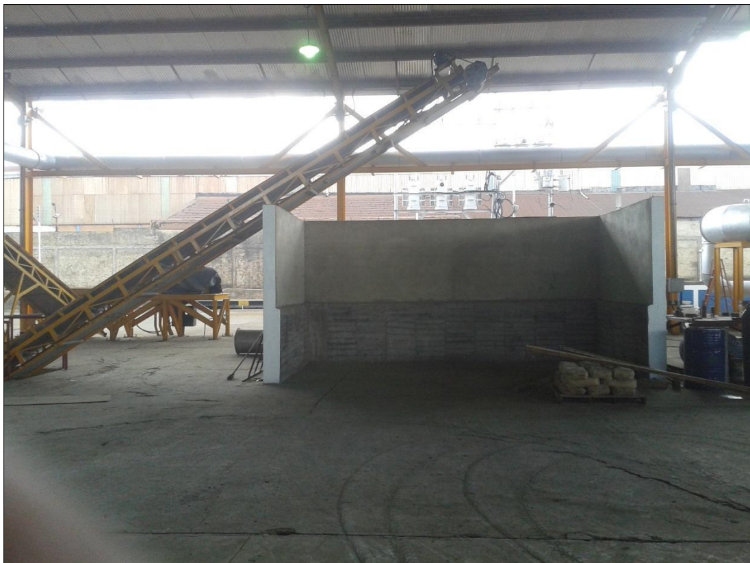
Cinta transportadora: Material limpio a bunker de almacenamiento
