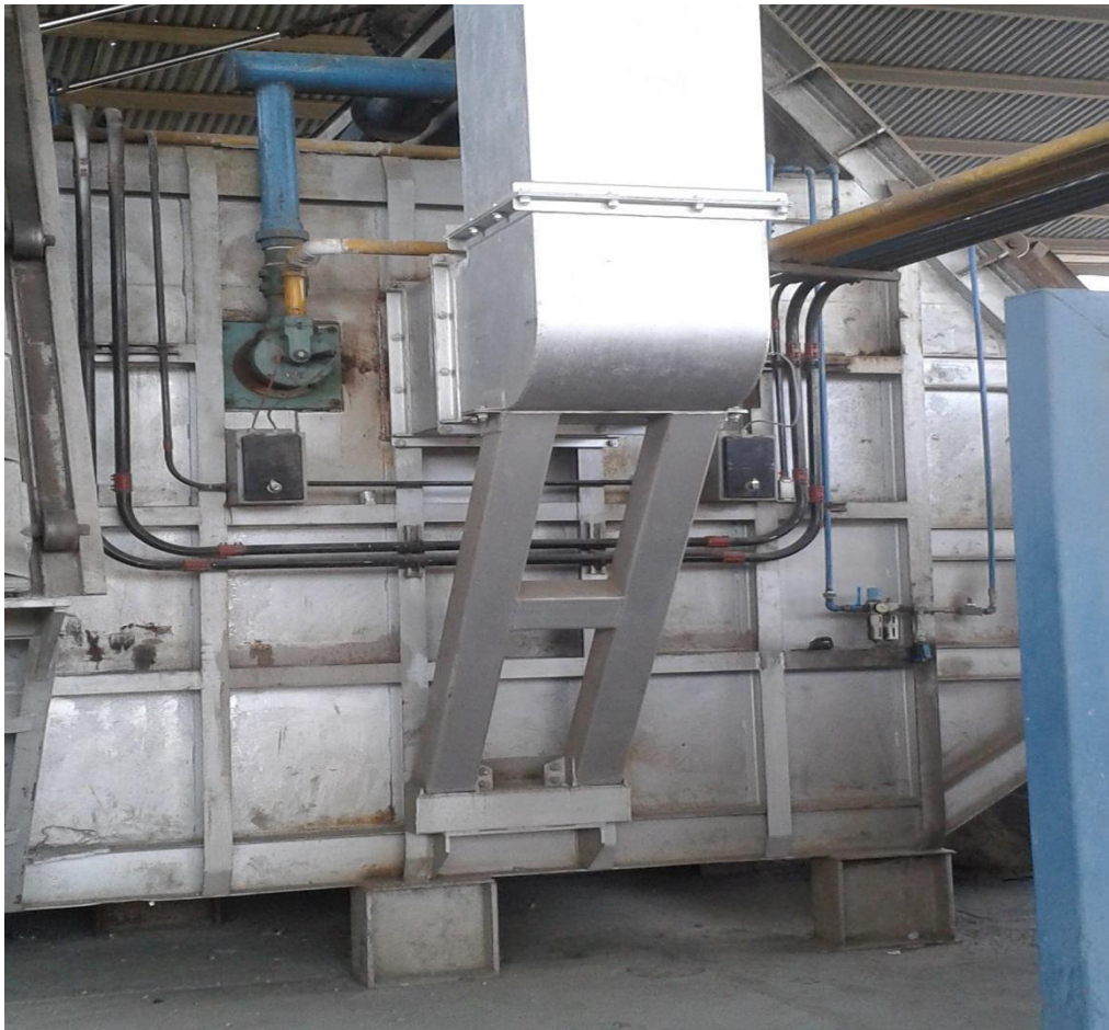
Quemadores de la cámara de carga
