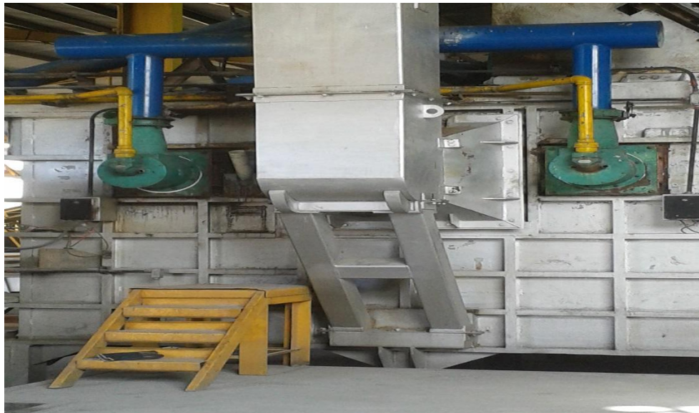
Sistema de combustión para fundición de material compuesto por (2) dos quemadores: Marca: Eclipse, capacidad: 18.000.000 btu c/u
